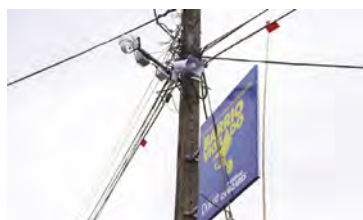
INSTALACIÓN DE CÁMARA Y ALARMA COMUNITARIA - BARRIO VIGILADO
